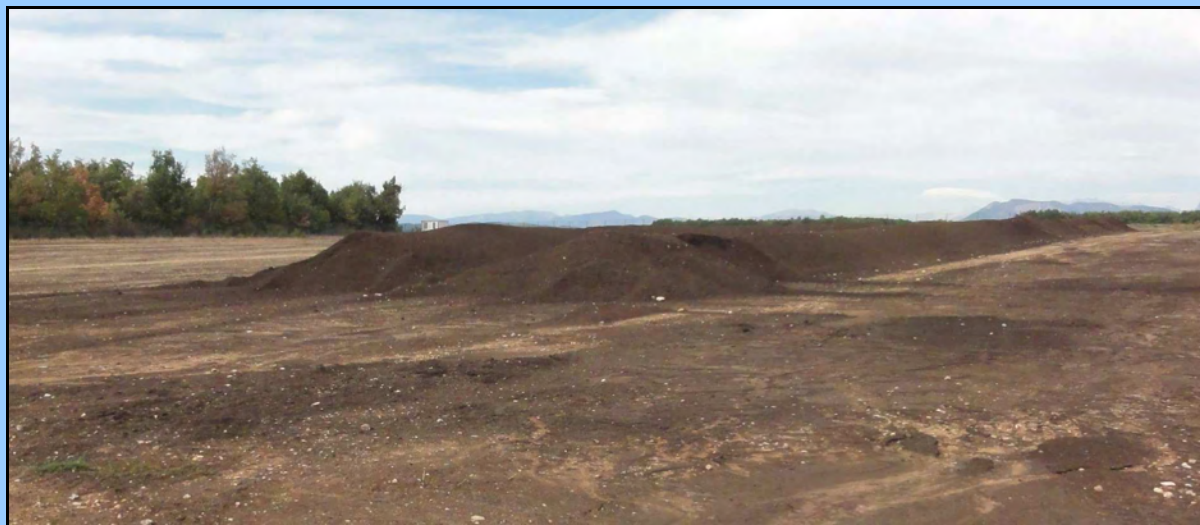
Figure 4 - Plateforme de compostage de boues et paille de lavandin (Sce : Parc du Verdon)
