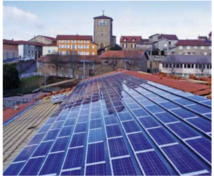
Toitsolaire à Saint-Laurent-de-Chamousset (69)
