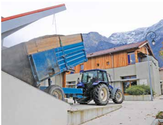
Alimentation de la chaufferie bois de la Rivière (38)
