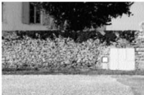
Compteur EDF-GDF incrusté dans un mur de pierre
