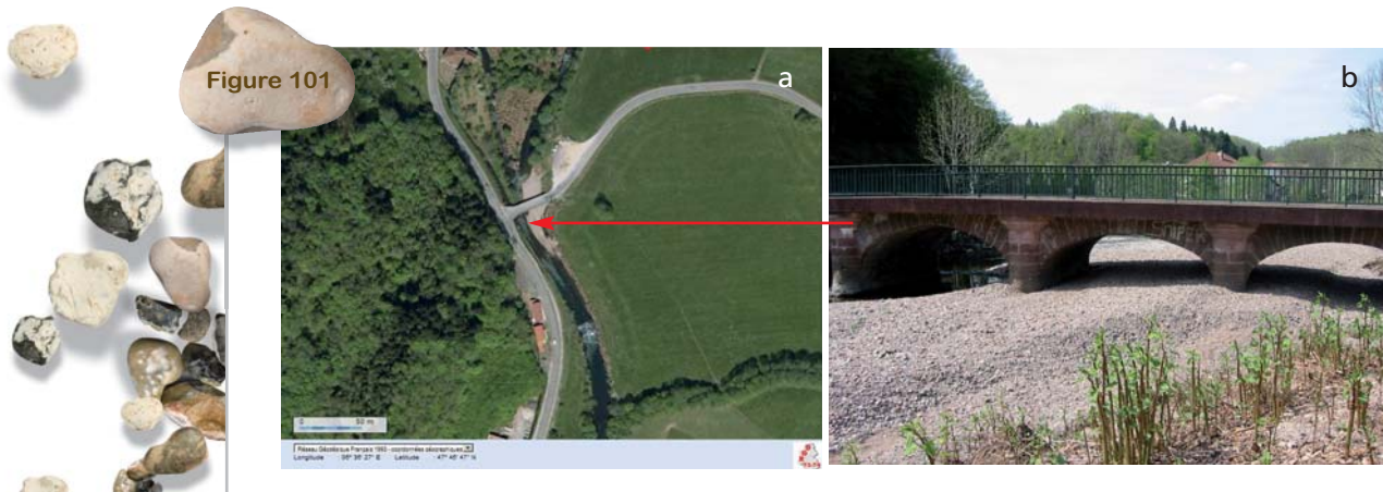
Exemple de pont bloquant plus ou moins temporairement le transport solide. C'est souvent l'élargissement du lit plus que l'ouvrage lui-même qui est la cause du sur-alluvionnement (surtout au droit de convexités de méandres...).
