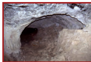
Photo4 : Cisaillement d'une conduite forcée - Phreatic drain shearing.
